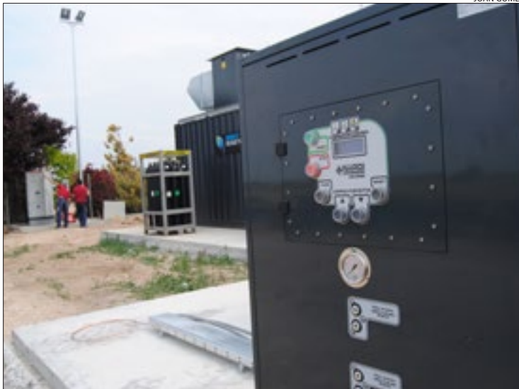
Un dels dispensadors de gas per a vehicles.
