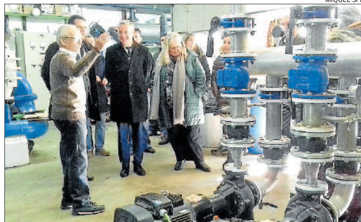
Les autoritats visiten la sala de les màquines noves on es genera el gel
