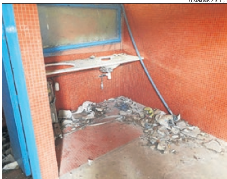
Imatge de l'estat de la pista poliesportiva de Castellciutat.
