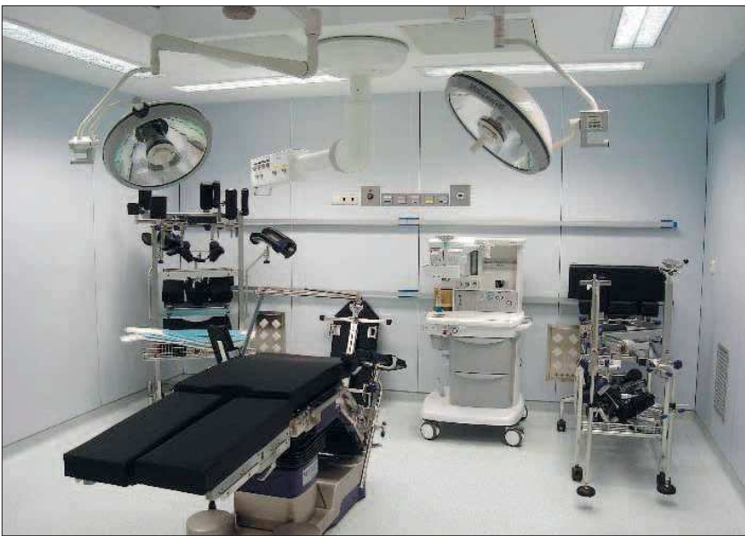
►► Instal·lacions del Sant Hospital de la Seu d'Urgell.
