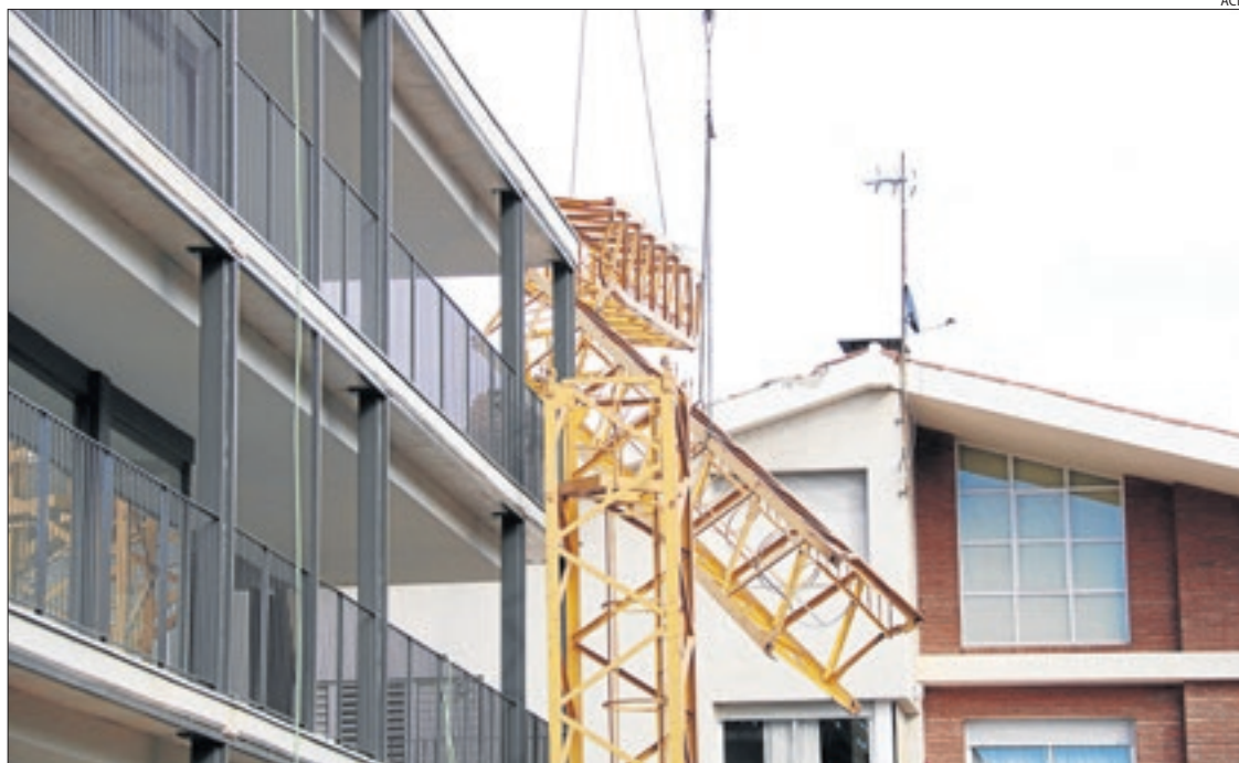
Fragment de la grua, que es va trencar i va caure sobre una casa de tres plantes ahir a Sant Just Desvern.
