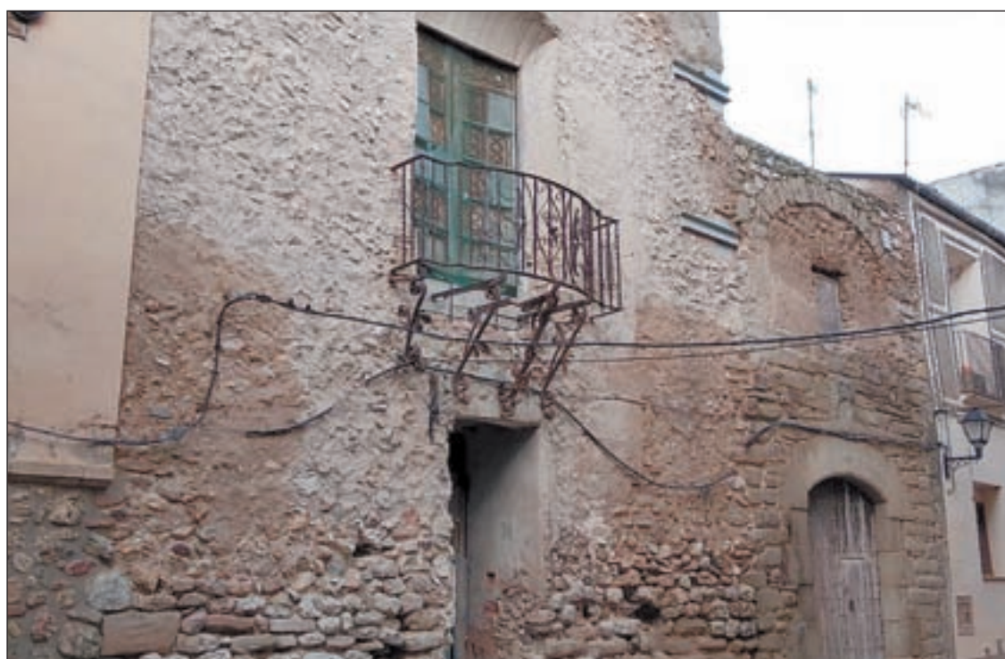
FOTO: Francisca Muñoz / Estat actual de la façana principal del Castell de Peramola, al Cap del Carrer
