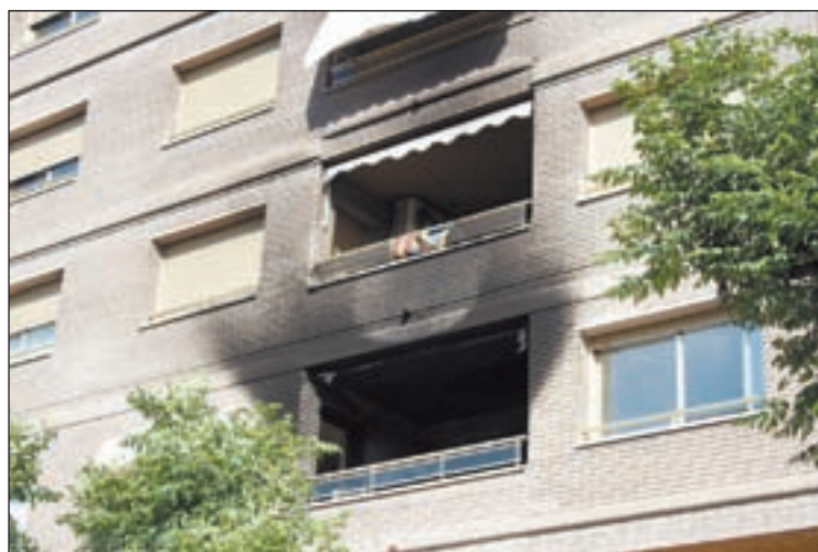
FOTO: T. Alcántara / La fachada del edificio se vio afectada por el humo
