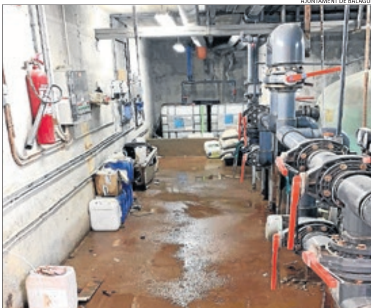
La sala de màquines després de treure'n tota l'aigua acumulada.
