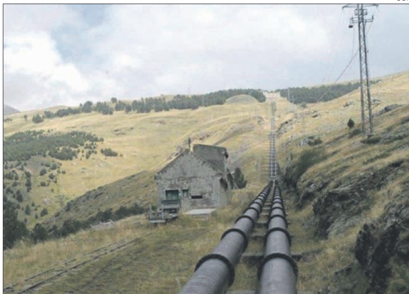
► Part de les instal·lacions de les hidroelèctriques de la Vall Fosca.
