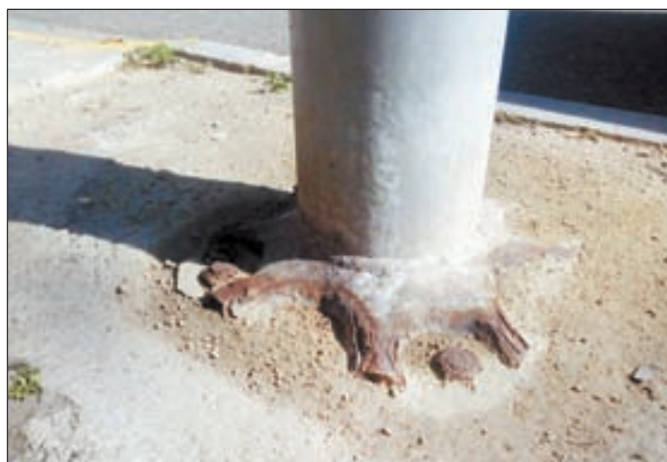
FOTO: D.A. / Una de las farolas con la base visiblemente oxidada
