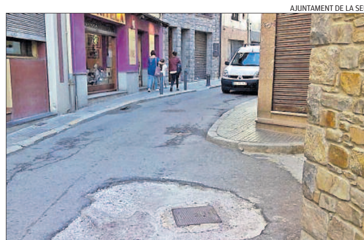
Els sots i zones de ferm irregular del carrer abans de les obres
