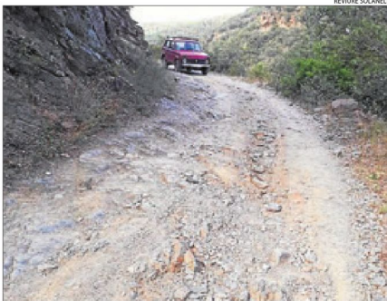
L'accés presenta un greu estat de deteriorament.
