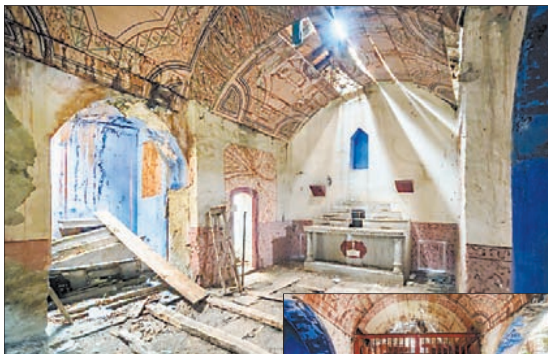
FOTO: Jaume Cardona / Aquestes són imatges recents del temple. Es veu perfectament que la teulada ja ha començat a cedir i que l'interior està totalment destrossat.
