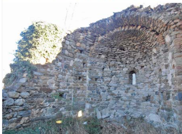
Forats al mur sud on suposadament hi havia el cor (2015)
